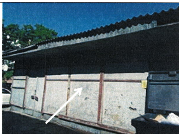
Pav. 4 Nusidėvėjęs iki ribinio būvio pastato sienų plokštės, jos sudrėkusios ir išlūžusios.
