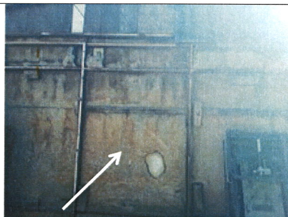
Pav. 2 Nusidėvėjęs iki ribinio būvio pastato sienų plokštės, jos sudrėkusios ir išlūžusios.
