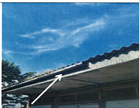
Pav. 9 Trūksta dalies lietvamzdžių, esamose auga augalai.
