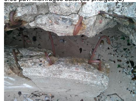
3.06 pav. Melnragės baterija, pavojingai styranti armatūra (1).
