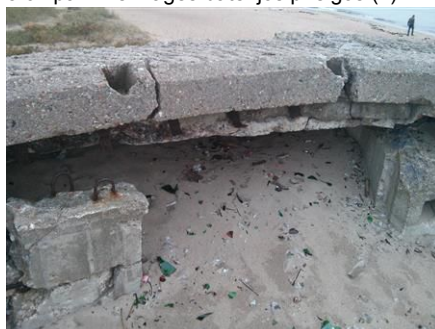
3.05 pav. Melnragės baterijos prieigos, pavojingai styranti armatūra
